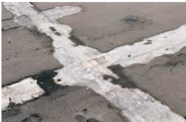
De slijtlaag was op veel plaatsen ernstig beschadigd.
