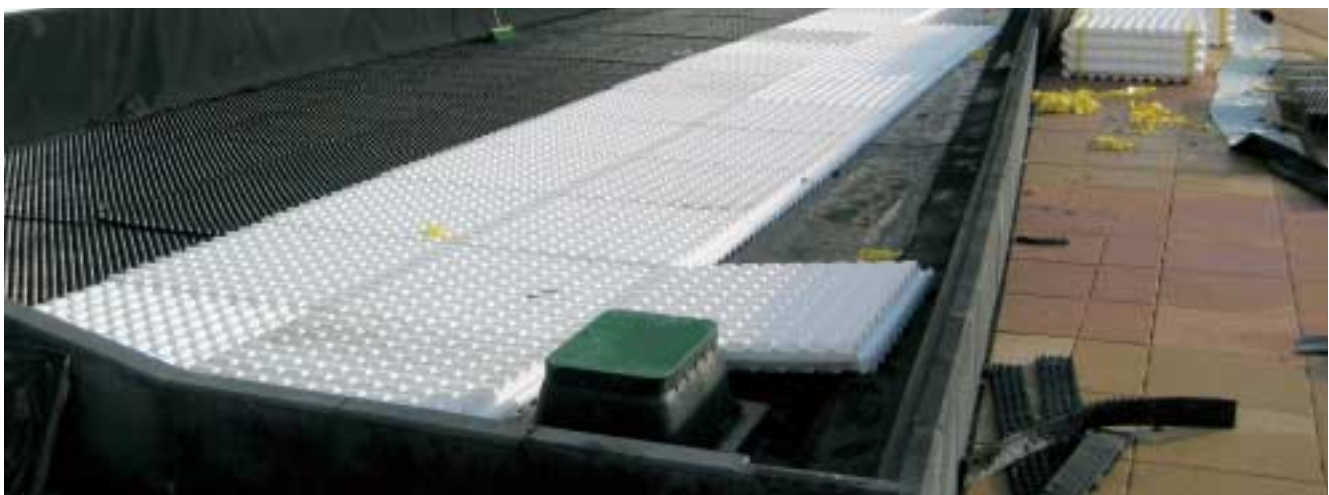
De plantenbakken zijn ingericht met twee drainagesystemen vanwege het gewicht.
